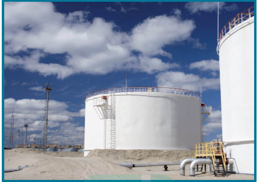
خزانات النفط في الكويت
